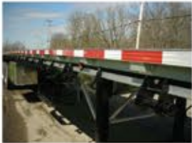
Larguero occidental con cabrestantes angulares fijos y ganchos de correa fijos
